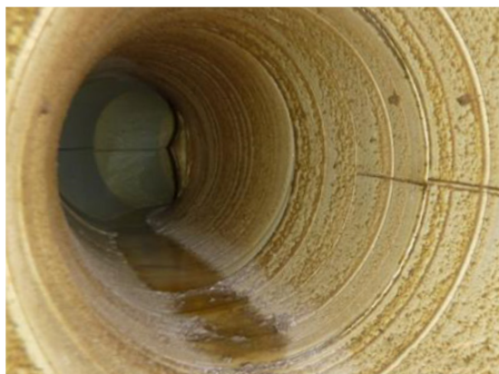
Imkanal utan ozonreningssystem
