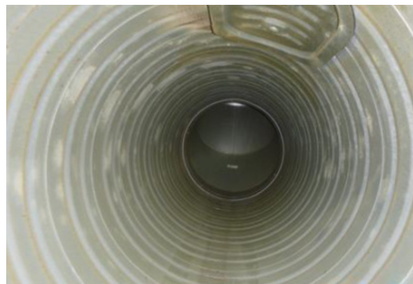
Imkanal med ozonreningssystem
