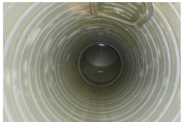
Imkanal med ozonreningssystem
