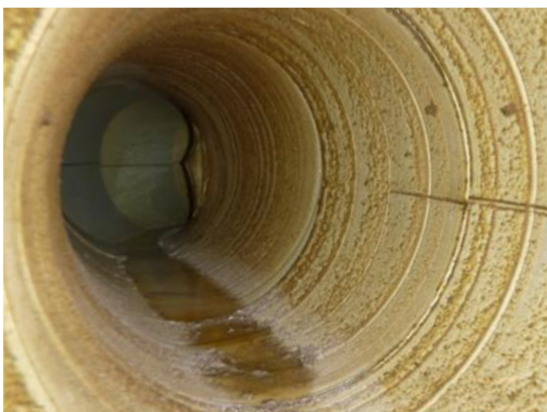
Imkanal utan ozonreningssystem
