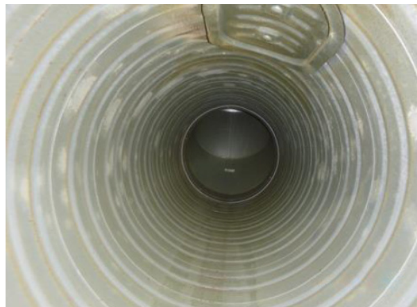
Väljatõmbetorustik osooni puhastussüsteemiga
